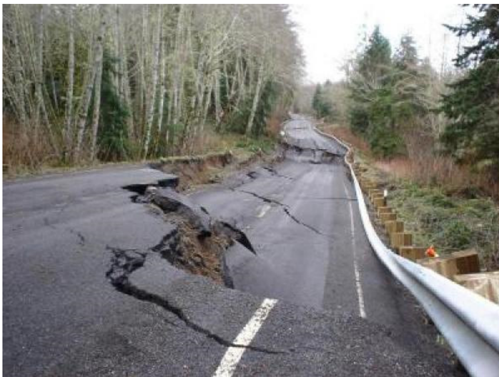
Рис. 2 Оползни на дорогах
